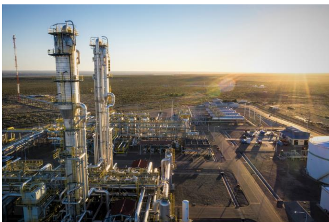
MEGA's Loma La Lata Plant
